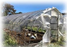
被害にあったビニールハウス
